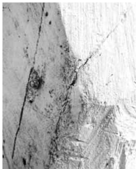
圖 14 作品長期倚靠牆面所形成的腐朽菌——修復中（朱銘美術館提供）
