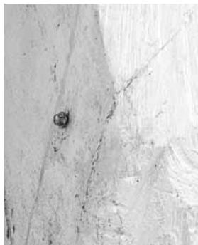
圖 15 作品長期倚靠牆面所形成的腐朽菌——修復後（朱銘美術館提供）
